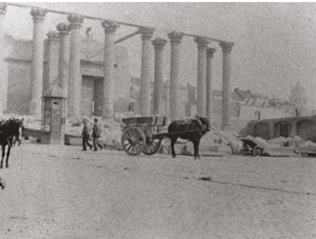
Brussel, Gerechtplein, de afbraak van het oude Justitiepaleis in 1892. Op de achtergrond rechts de koepel van het nieuwe Justitiepaleis.
